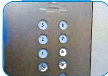
エレベーターのボタン
